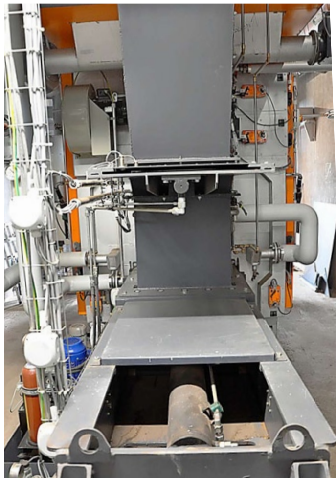
Eine eingehaute Kratzkette transportiert den natürlichen Brennstoff in den Ofen (im Hintergrund). Fotos: Matthias Mayer
