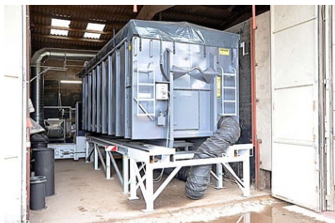
Zwei dieser Container mit Ast-Schnitt stehen in der Heizzentrale. Leere Container werden in Stausebach wieder befüllt.
