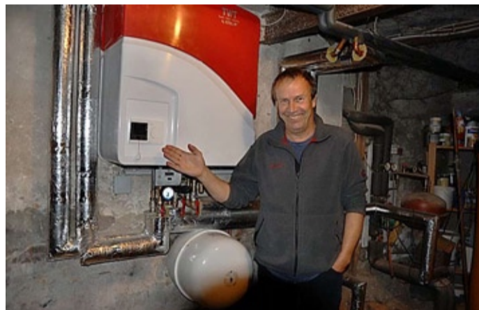
Statt eines Heizkessels braucht Martin Methfessel nur noch diese kompakte Übergabestation, um sein Haus zu beheizen.
