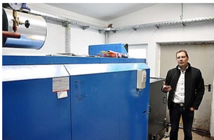
Wenn alle Stricke reißen, muss der Flüssiggas-Kessel ran. Dr. Oliver Bastian erklärt das Backup-System.
